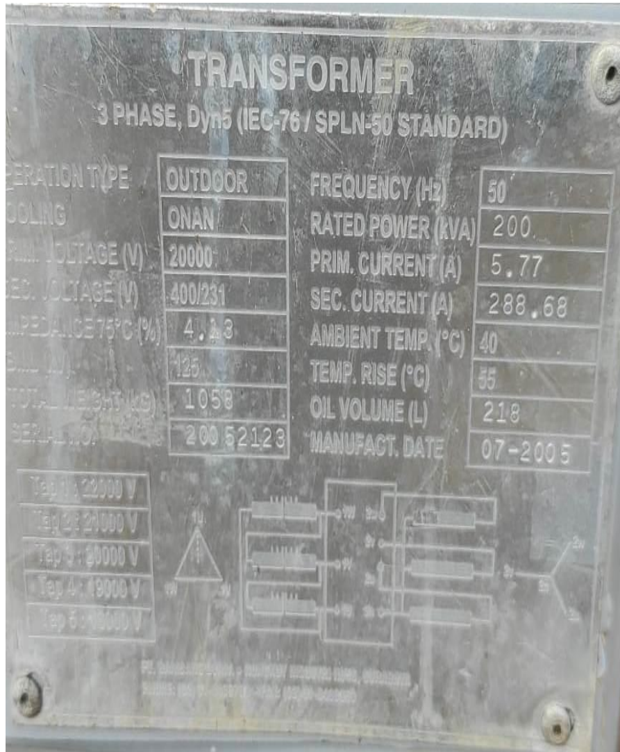
Nameplate Transfromator KRGK 0136 Sebelum Uprating Transformator
