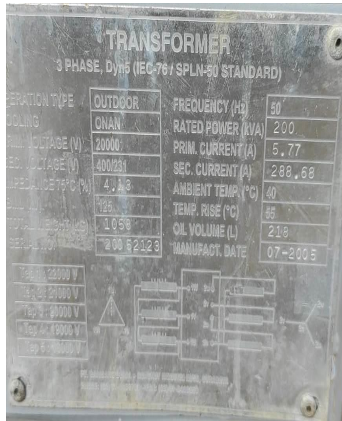
Gambar 4.1 Nameplate Transformator 200 kVA No.Seri 20052123
